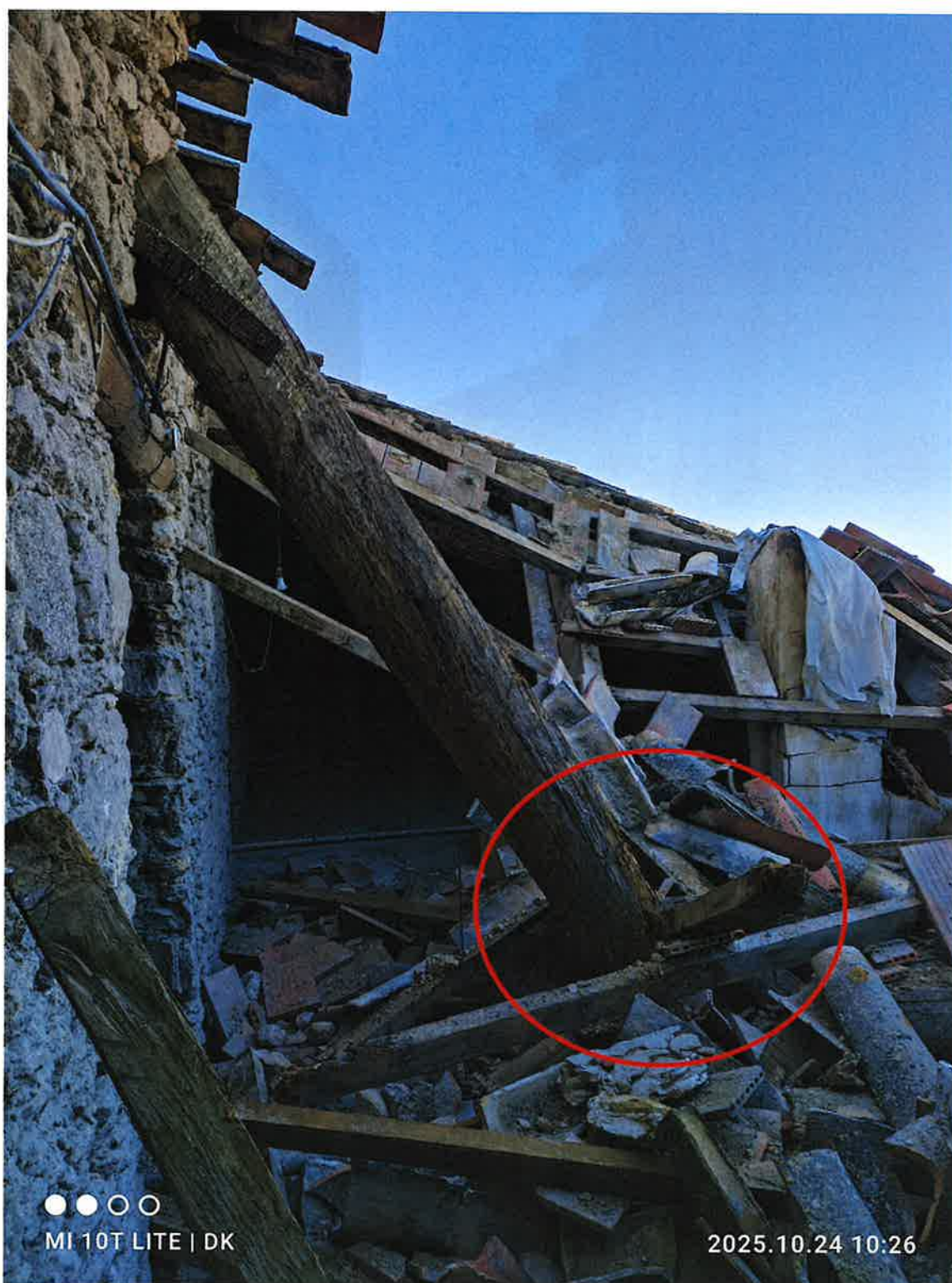
Photo 02 – rupture poutre maitresse
