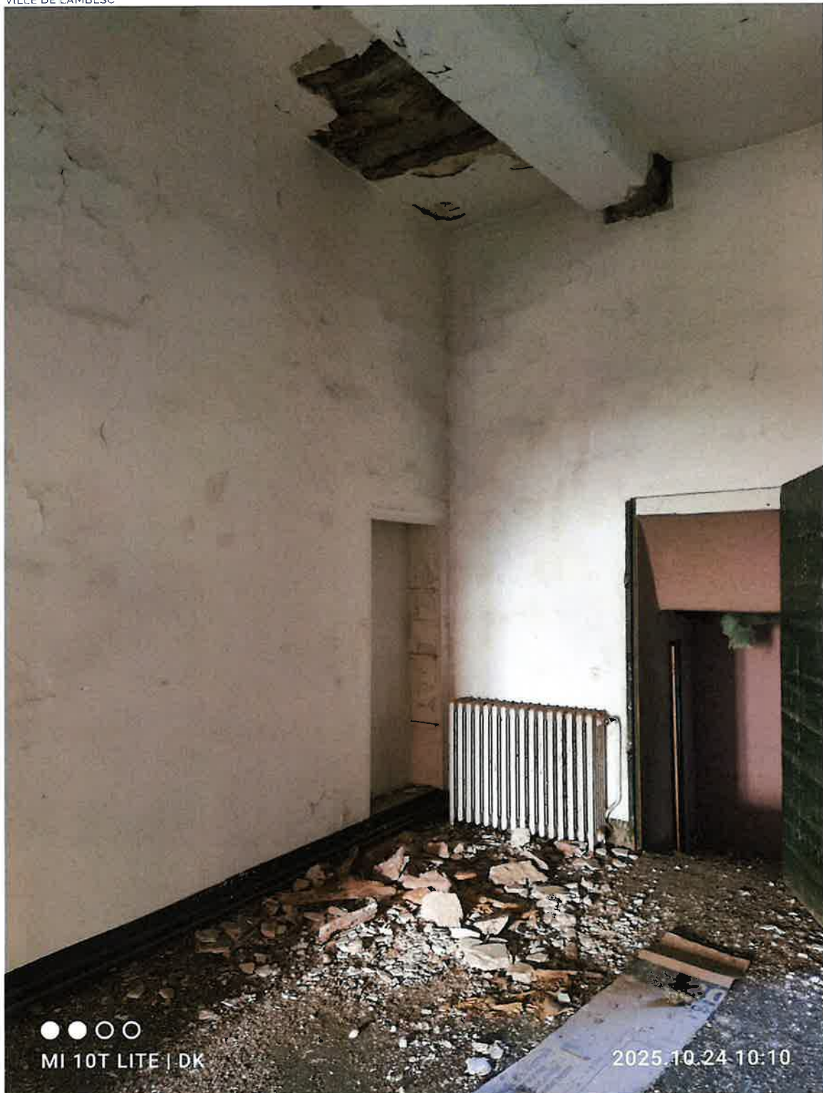
Photo 11 – impact au R+1 (plancher R+2) – effondrement ponctuel plancher
