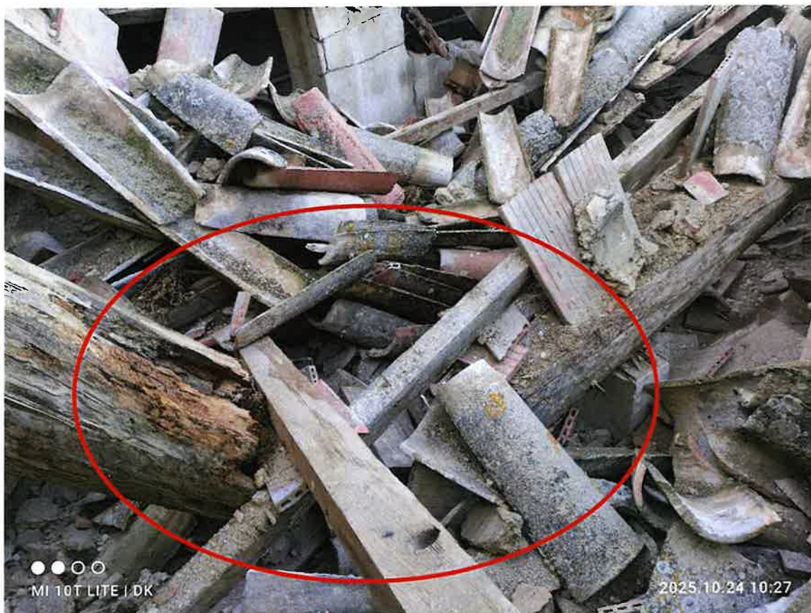
Photo 03 – rupture poutre maitresse
