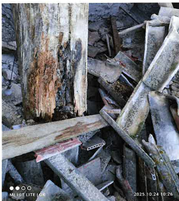
Photo 04 – rupture poutre maitresse – état de la poutre
