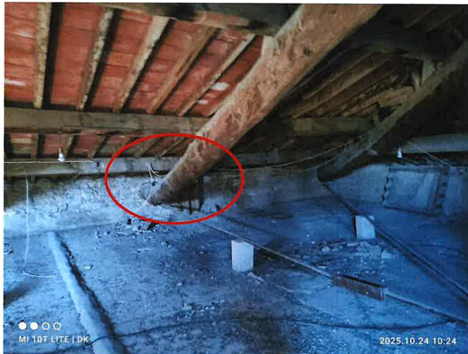
Photo 10 – alerte sur état de la poutre maîtresse en toiture Sud et point de rupture imminent
