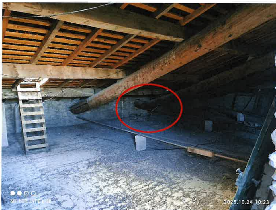
Photo 09 – alerte sur état de la poutre maîtresse en toiture Sud
